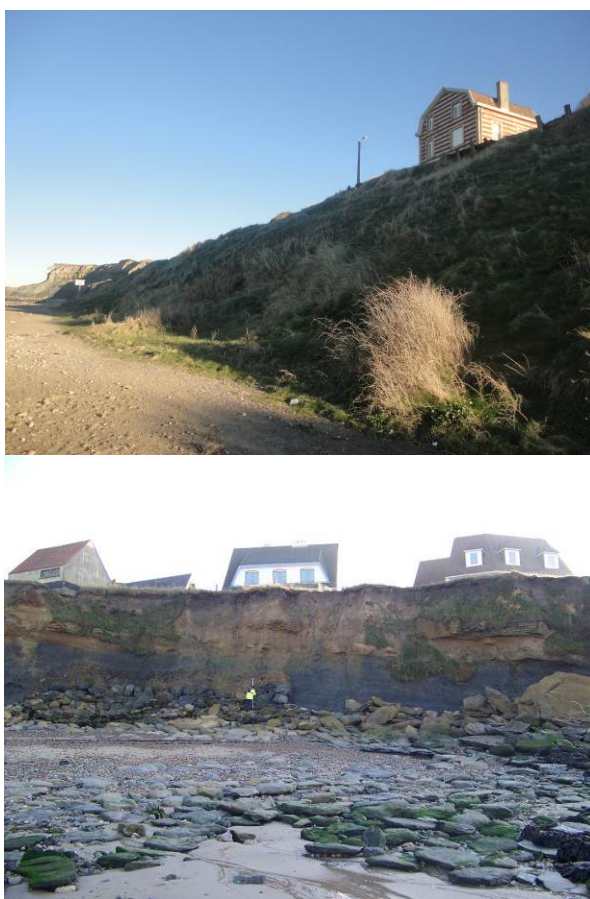
Figure 41 : Propriétés en arrière de la corniche de la falaise au nord de Wimereux (gauche) (Egis, Décembre 2013) et au nord d'Audresselles (DDTM62, 2013)
