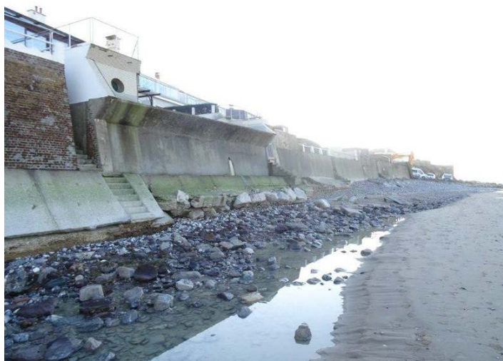
Figure 51 : Signes d'abaissement de l'estran et de l'affouillement du mur de soutènement à l'ouest de la digue (Egis, Hiver 2013-2014)
